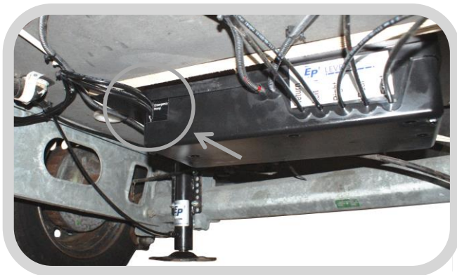
Pumpengehäuse mit Anschlüssen der Notbedienung.
